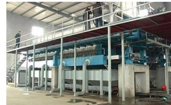
常州某污水处理厂（含水率80%污泥200T/D,处理后含水率≤60%）
