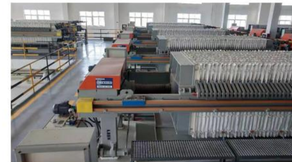
江西上饶某污水处理厂（日处理规模150000T/D）
