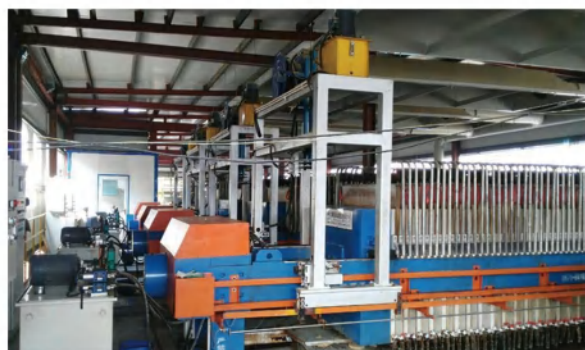
华北制药发酵液菌渣过滤项目
