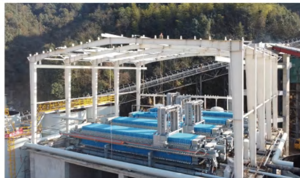
2000吨每小时砂石骨料污水处理工程EPC总承包项目
