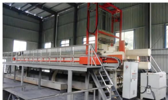
福建某电镀集控区电镀污水处理项目
